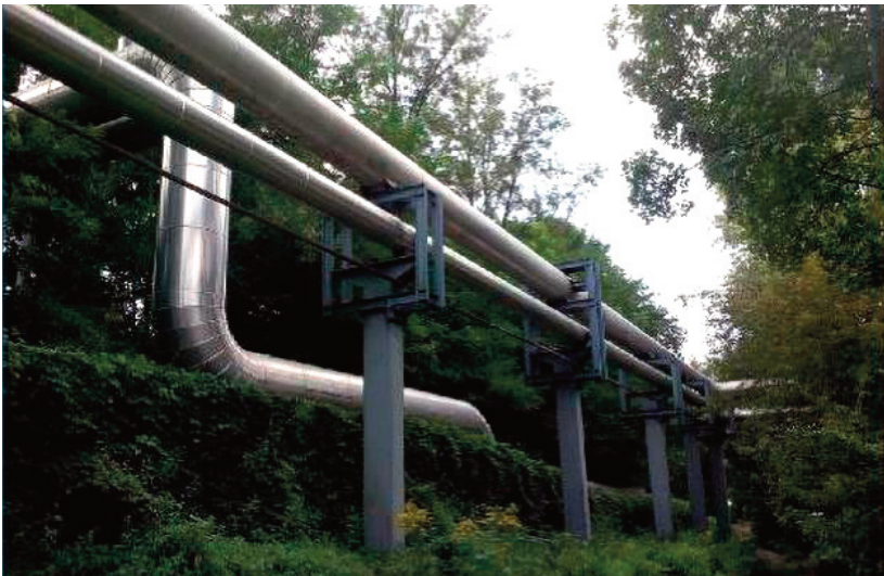
Abb. 3.2.3.1: Fernwärmeleitung Quelle: Dr. Born – Dr. Ermel GmbH
