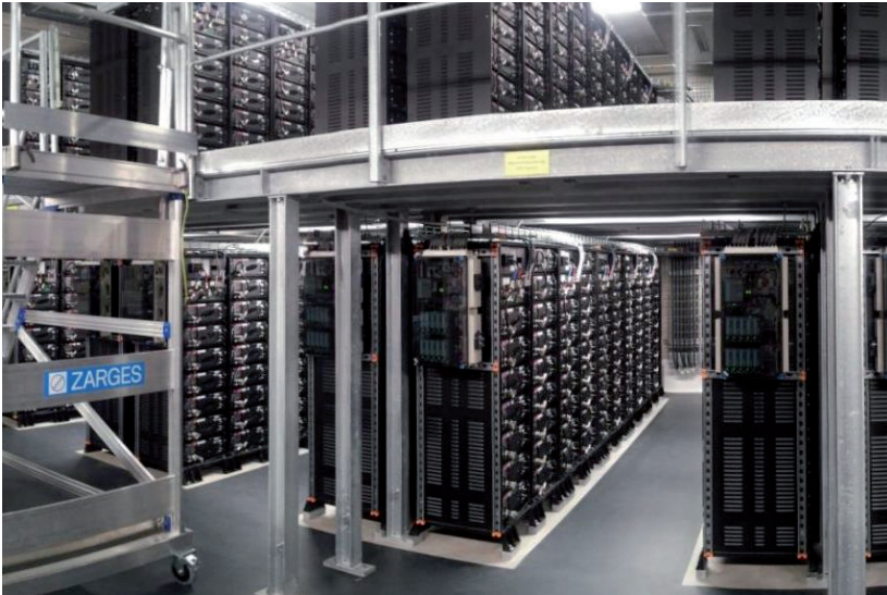
Abb. 3.3.3.2.5: Innenansicht des ersten kommerziell Batteriekraftwerks in Europa: Die Lithium-Ionen-Batterien mit 5 MW Leistung stellen etwa das Regelpotenzial einer konventionellen 50 MW Turbine bereit | Quelle: WEMAG
