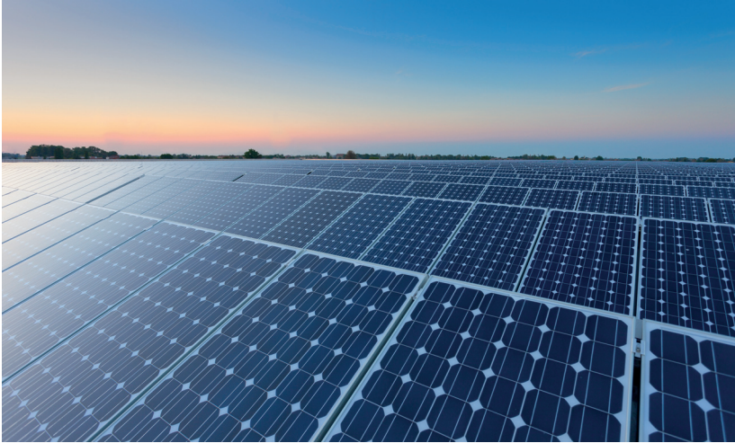
Abb. 6.1.1: Photovoltaik-Freiflächenanlage | Quelle: Fotolia
